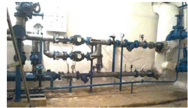
Рис. 3 Автоматизований вузол регулювання теплової енергії навчального корпусу №6
