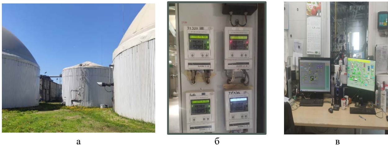
Рис. 1. Біогазові установки, в яких відбуваються послідовні процеси ферментації: а – біогазові установки, б – датчики контролю за процесом ферментації, в – пункт оператора (автоматичний контроль процесу ферментації відходів)
